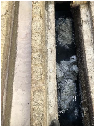
Figura 14: Canales conductores de agua de teñido y cromo procedentes de la zona de curtido y recurtido.
