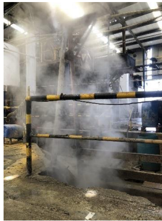
Figura 9: Gases generados en el tanque de sebo.
