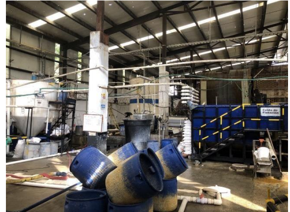
Figura 7: Registro del acompañamiento a la Planta de Tratamiento de Aguas Residuales.
