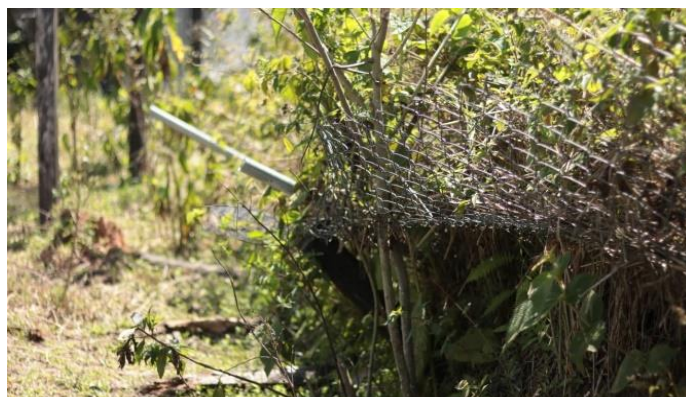
Figura 4. Cerramiento perimetral en mal estado
