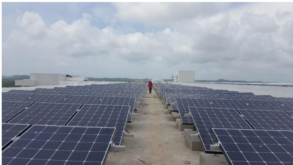
Ilustración 7. Instalación solar fotovoltaica
