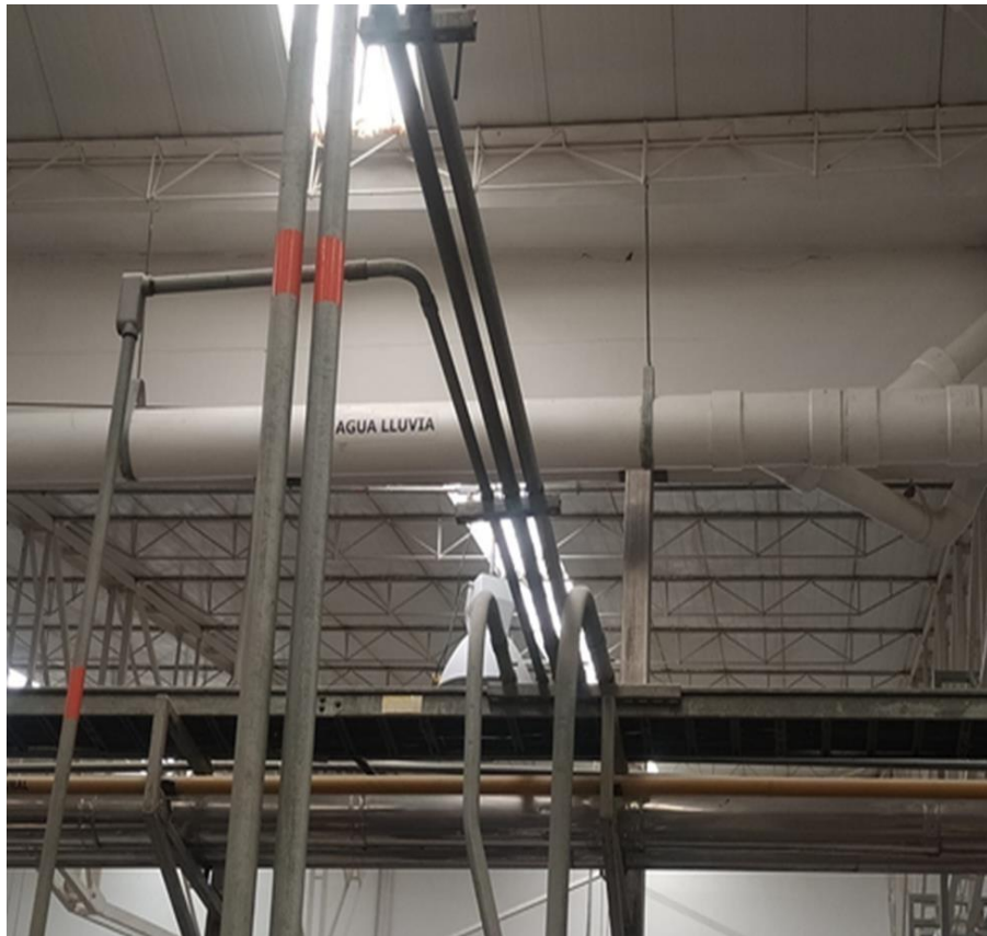
Ilustración 8 Captación de agua lluvia para Reúso
