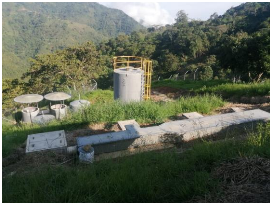
Planta de Tratamiento de Aguas Residuales
