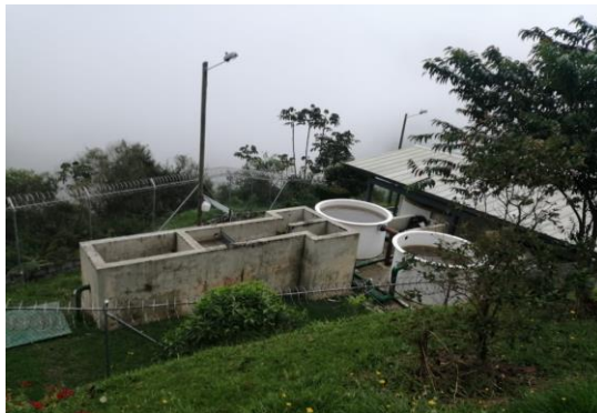
Canal de entrada PTAR
