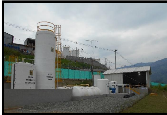
Ilustración 15 planta de aguas residuales
