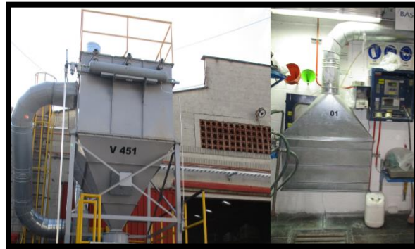
Ilustración 30 Sistema de material particulado
