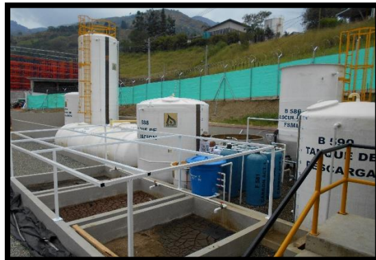
Ilustración 16 planta de aguas residuales
