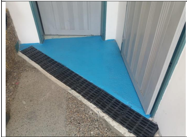
Ilustración 8. Cárcamo para conducción de agua
